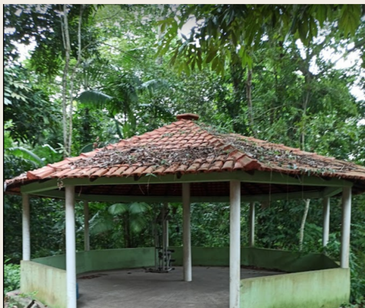
Situação de descaso e abandono na área do Parque Ambiental Gunnar Vingren.
