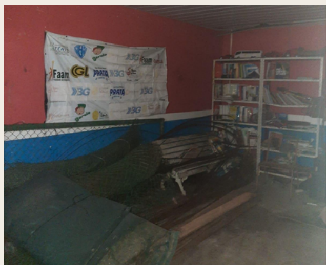
SITUAÇÃO EM QUE A DIRETORIA ENCONTROU A SEDE ADMINISTRATIVA DA AMME - EM COMPLETO ESTADO DE ABANDONO
